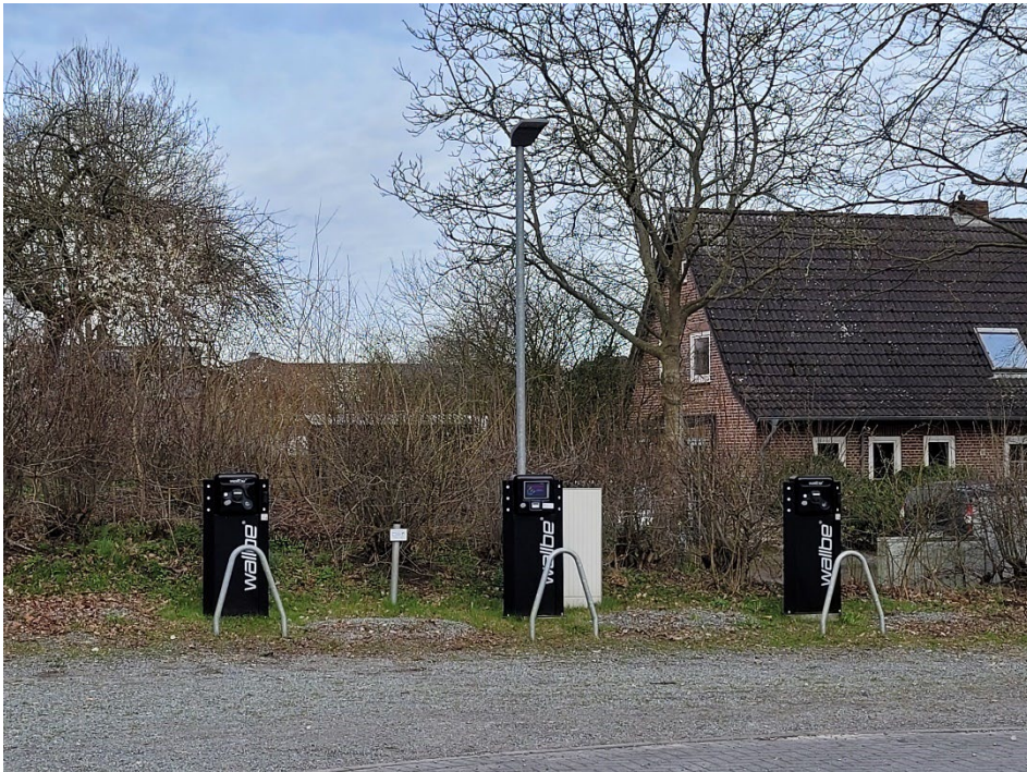
Abbildung 30: Ladestationen in Sieverstedt vor der Sporthalle (Quelle: eigene Aufnahme)
